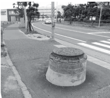
浦安市：液状化により道路が沈下し、マンホールが歩道に盛り上がっている
